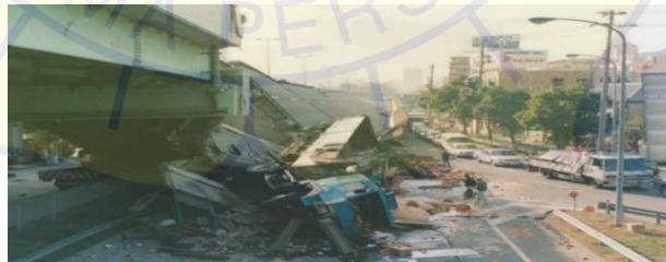
Gambar 2.1 : Reruntuhan Jalan yang Diakibatkan Gempa di Kobe
